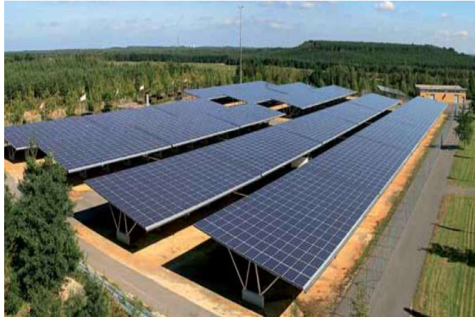
Source : IBC SOLAR AG, Schletter
