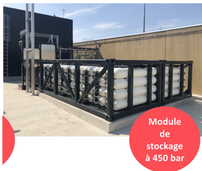
Figure n° 12 - Exemple de stockage haute pression 18
