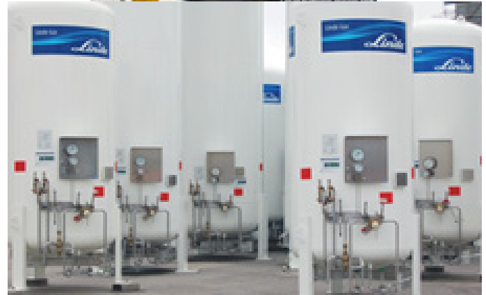
Figure n° 14 - Exemples de réservoirs d'hydrogène liquide 20
